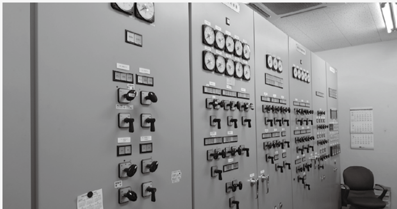
浄水処理施設制御パネル (24時間365日この機器が働くことにより水を供給しています)
