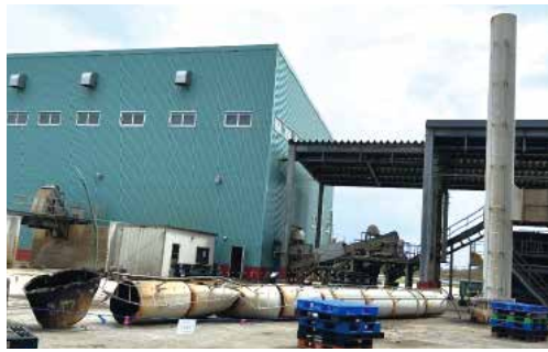
煙突被災状況、倒壊2日後(9月6日)
