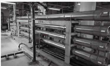
RO 膜処理ユニット
