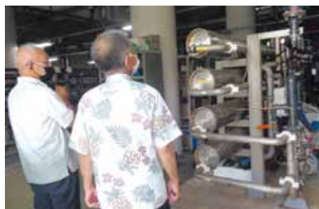
簡易水道施設の設備の監査
